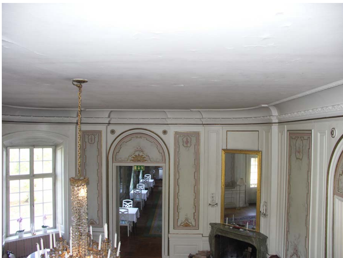
Bilden visar tydligt de omfattande färgsläppen som går ända ner till putsen. Sannolikt orsakat av felaktigt färgval som dragit loss underliggande färglager.
